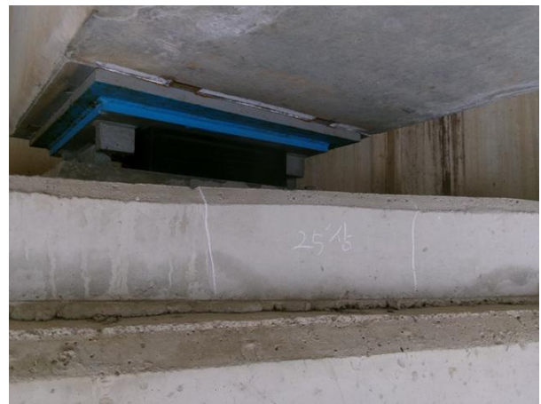
신기1교 교량받침 A2-SH2 받침콘크리트 균열 0.1/0.3*2EA
