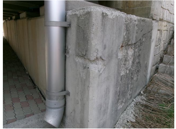
신기1교 교대 A2 구체 파손 0.4*0.4
