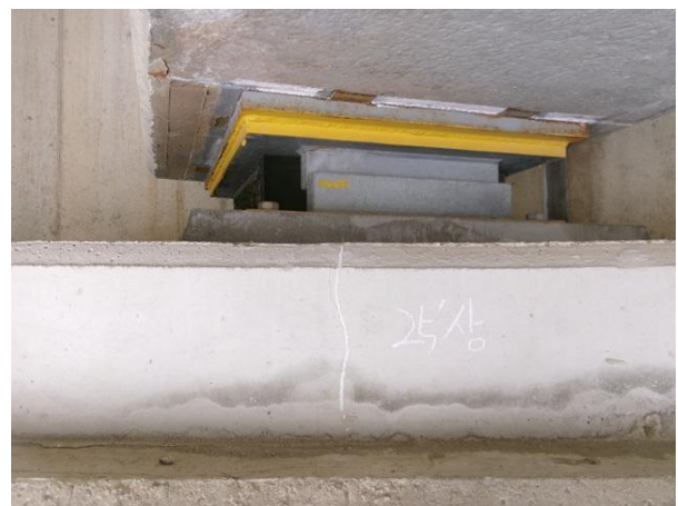
신기1교 교량받침 A2-SH4 받침콘크리트 균열 0.1/0.3
