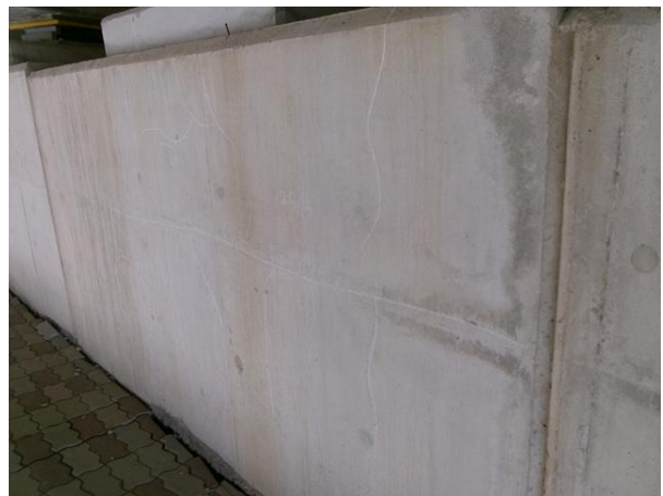
신기1교 교대 A2 구체 망상균열 2.0*1.5
