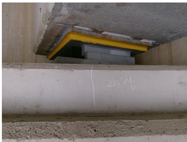
신기1교 교량받침 A2-SH3 받침콘크리트 균열 0.1/0.3
