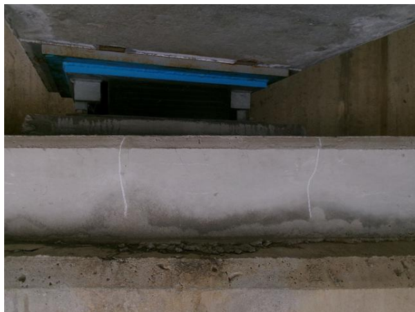
신기1교 교량받침 A2-SH7 받침콘크리트 균열 0.1/0.3*2EA
