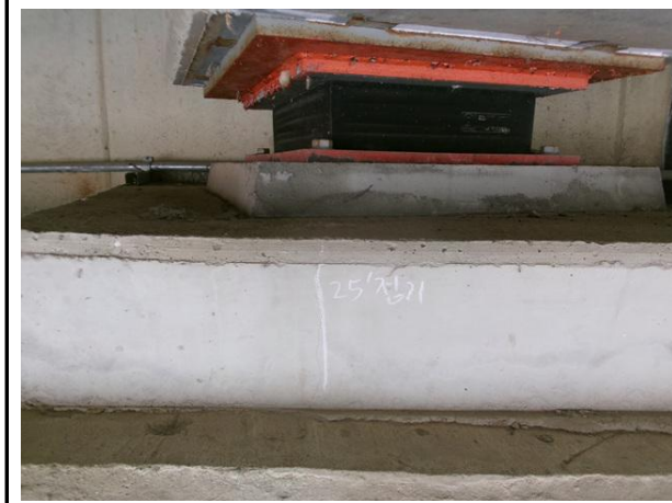
신기1교 교량받침 A1-SH5 받침콘크리트 균열 0.1/0.4_신규
