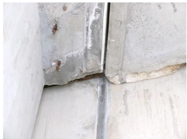
신기1교 바닥판하면 S1-A2 종조인트부 파손 0.4*0.2
