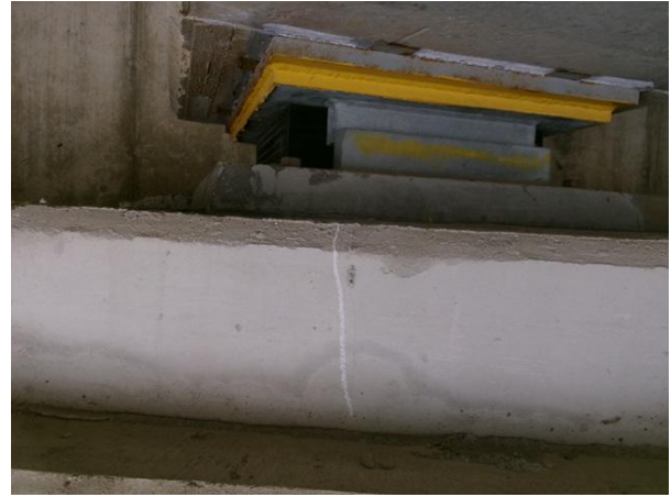
신기1교 교량받침 A2-SH6 받침콘크리트 균열 0.1/0.3
