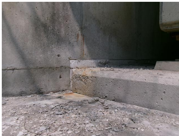
신기1교 교량받침 A2-SH1 받침콘크리트 박리 0.2*0.4
