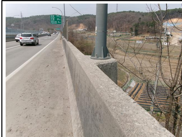
신기1교 수원방향 방호벽 S1 열화 0.5*40*2
