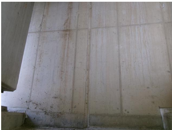
신기1교 교대 A2 흉벽 균열 0.2/1.5*2EA
