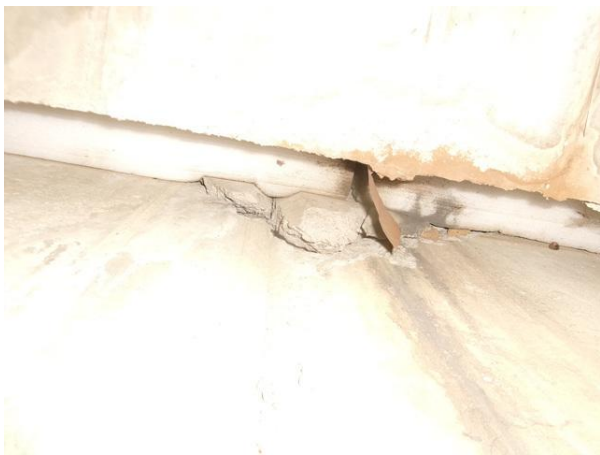
신기1교 교대 A1 파손 0.3*0.5_신규
