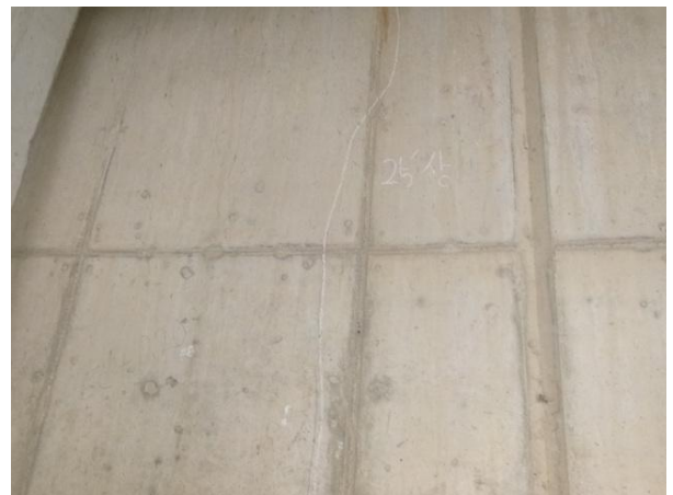
신기1교 교대 A2 흉벽 균열 0.2/1.5*2EA
