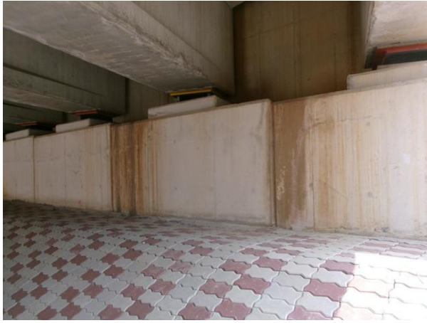
신기1교 교대 A1 누수흔적 1.5*1.0*2EA_신규
