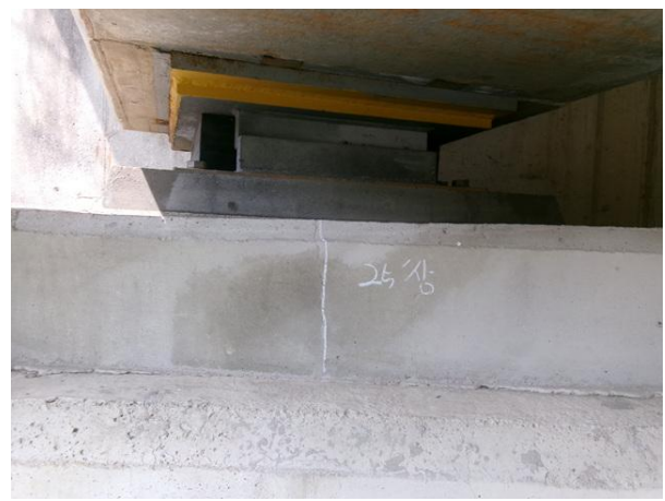
신기1교 교량받침 A2-SH1 받침콘크리트 균열 0.1/0.3
