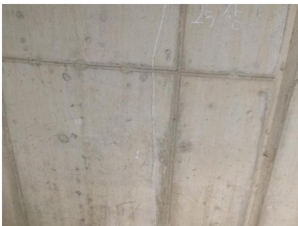
신기1교 교대 A2 흉벽 균열 0.3/2.5
