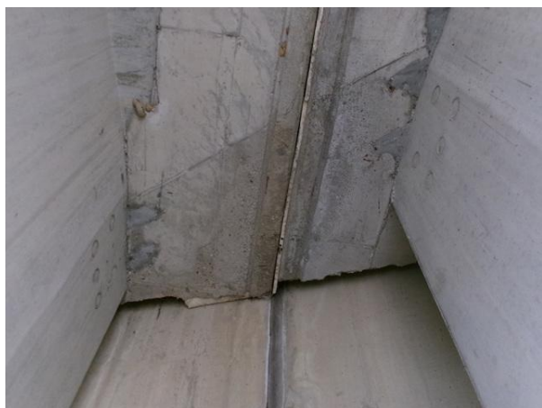
신기1교 바닥판하면 S1-A1 종조인트부 박리 1.0*0.5
