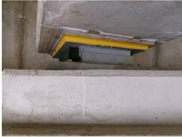
신기1교 교량받침 A2-SH5 받침콘크리트 균열 0.1/0.3
