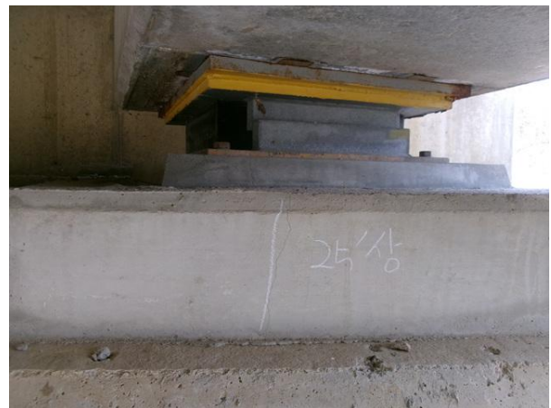
신기1교 교량받침 A2-SH8 받침콘크리트 균열 0.1/0.3
