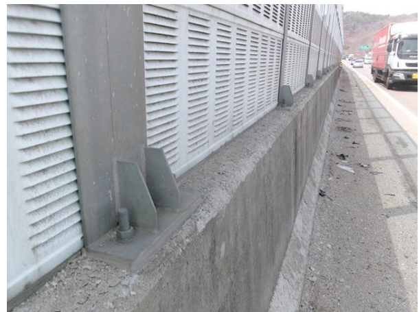
신기1교 이천방향 방호벽 S1 박리(열화) 0.3*40.0_신규
